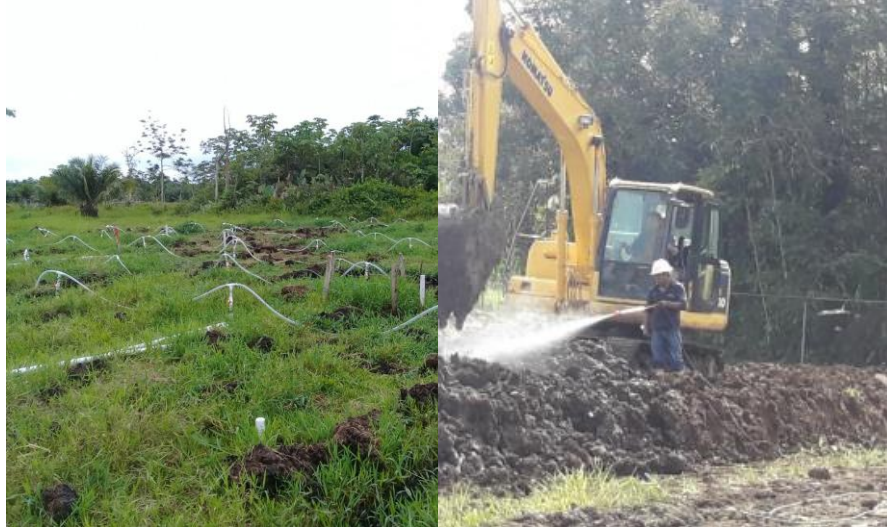
Figura 16. Proceso de aplicación de OSE II y aireación del suelo mediante montaje de red de tubería PVC (izq.) y proceso de aplicación de OSE II a través de bomba fumigadora y aireación del suelo mediante volteo mecánico por medio de excavadora (der.)
