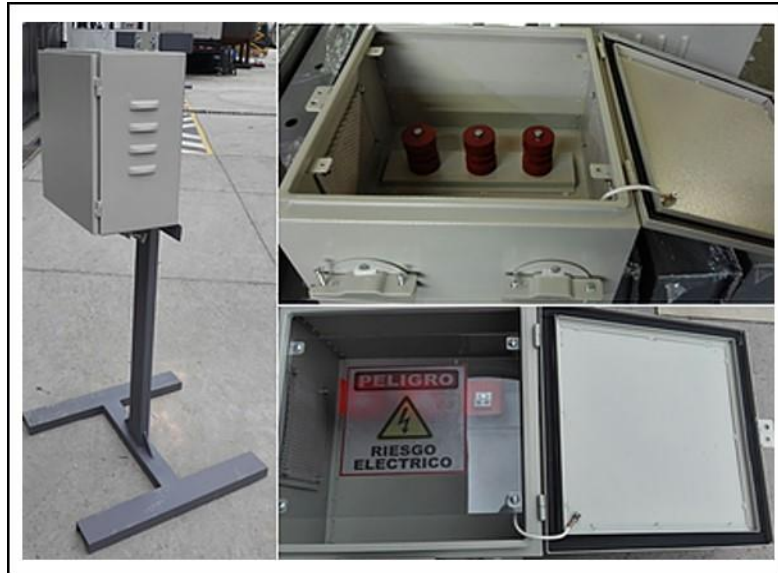
Figura 25. Equipo ESP: caja de venteo.
