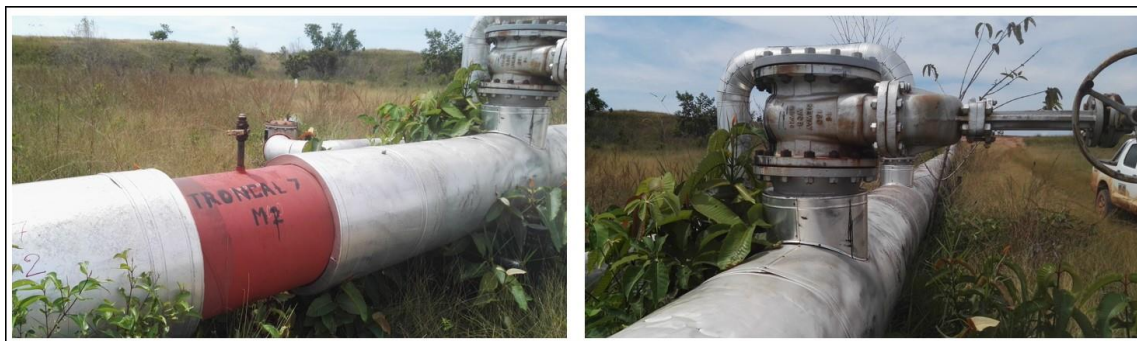
Figura 4. Líneas de flujo aisladas térmicamente
