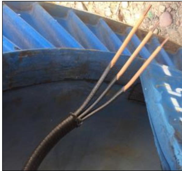
Figura 16. Cable de potencia con sus tres fases descubiertas
