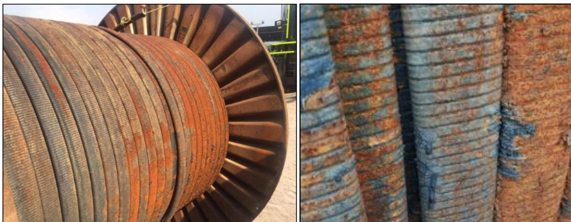
Figura 14. Cable altamente corroído
