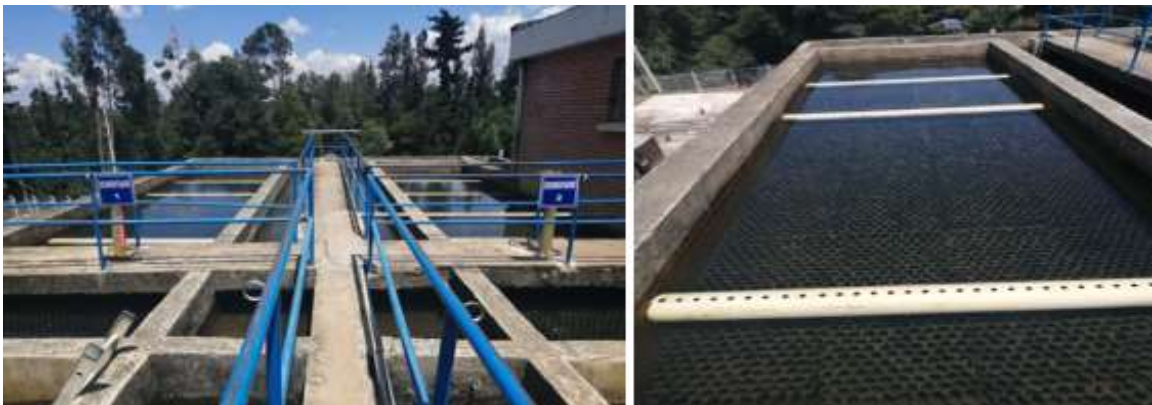
Figura 10 Sedimentación en la planta
