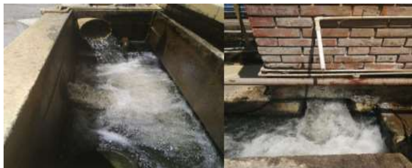
Figura 8 Cámara de Llegada y Mezcla Rápida
