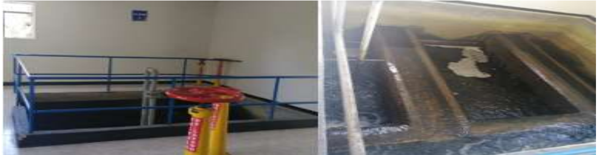
Figura 11 Filtro de la PTAP
