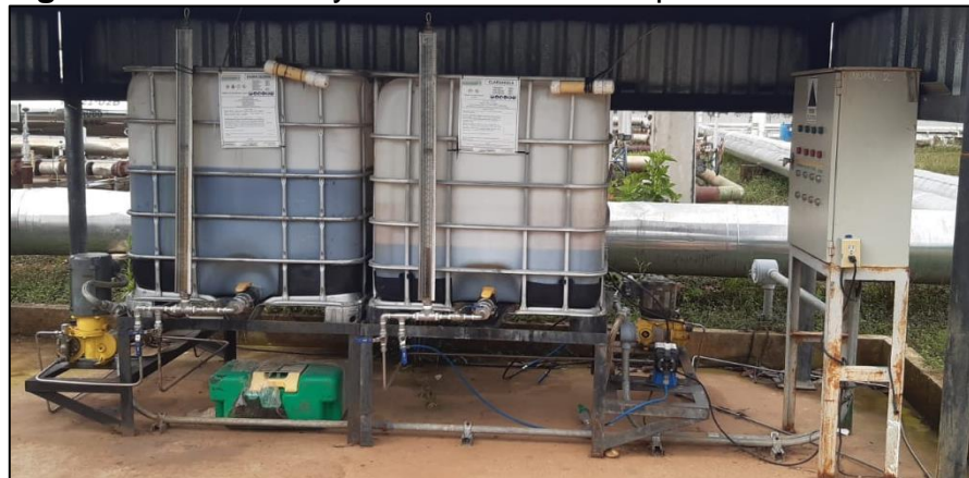
Figura 16. Skid de inyección tratamiento químico.
