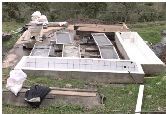
Figura 16. Albercas de decantación, Fosca
