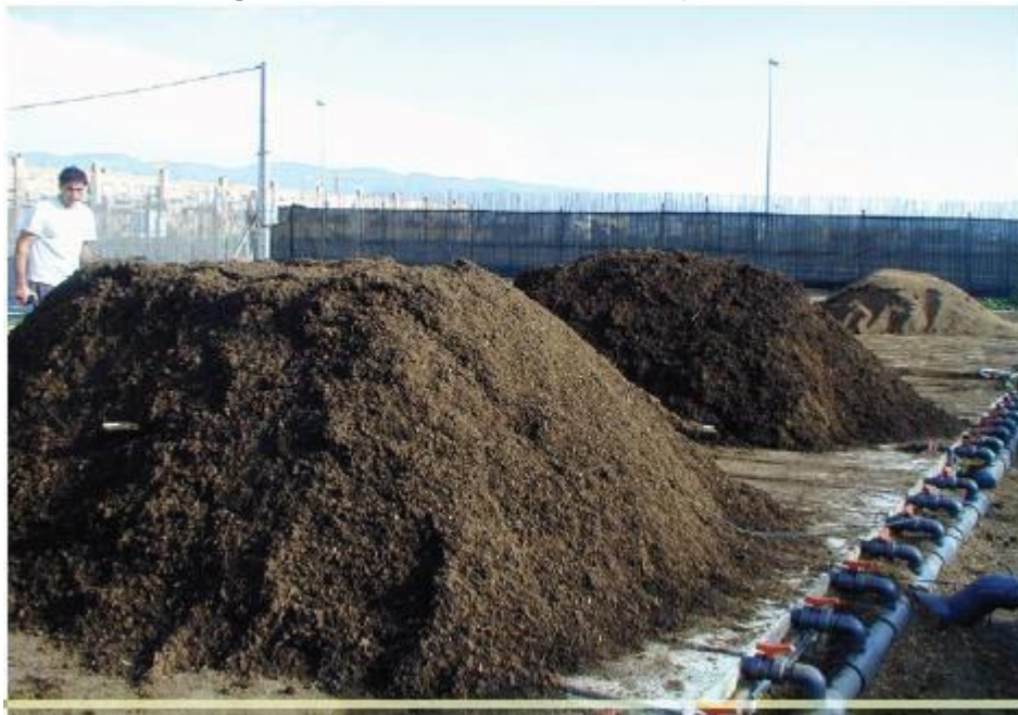
Imagen 1. Sistema de aireación de pila estática.
