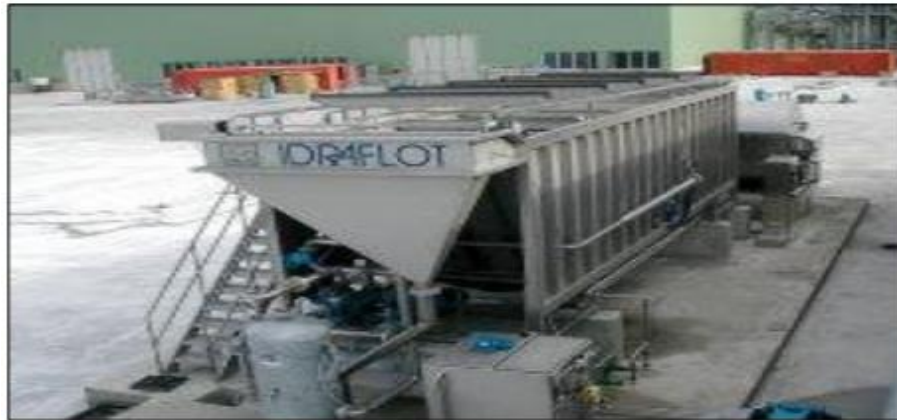
Figura 19. Separador de flotación por gas disuelto.
