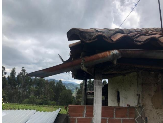
Red de canaletas
