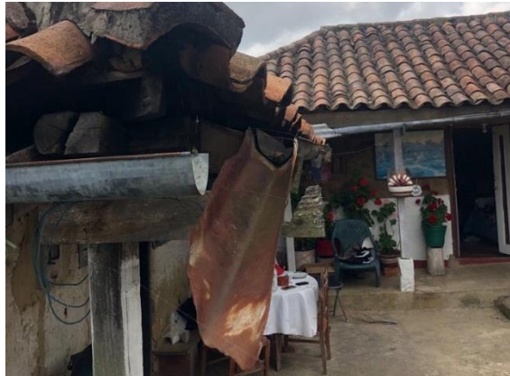
Red de canaletas
