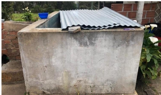
Tanque de almacenamiento
