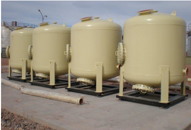
Figura 55. Filtro de carbón activado.
