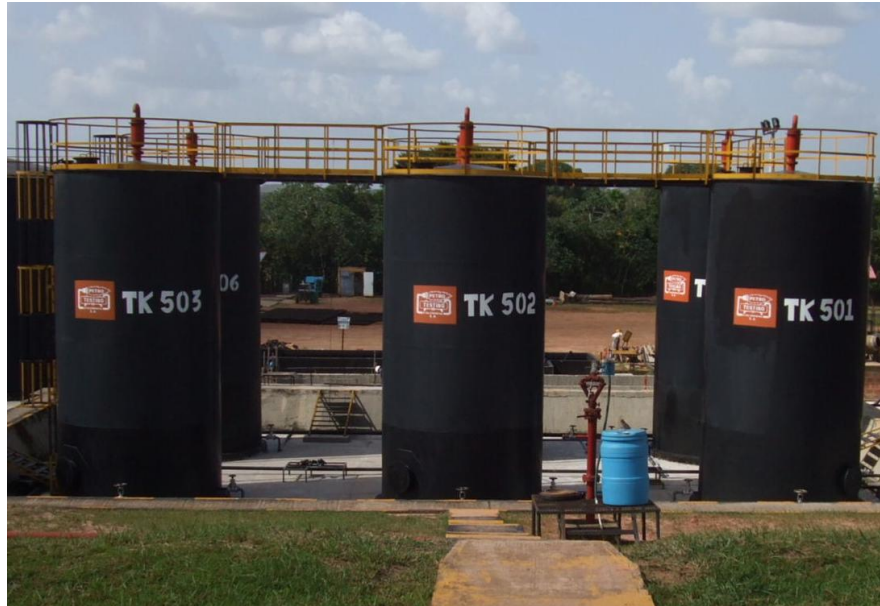
Figura 21. Imagen de tanque de almacenamiento
