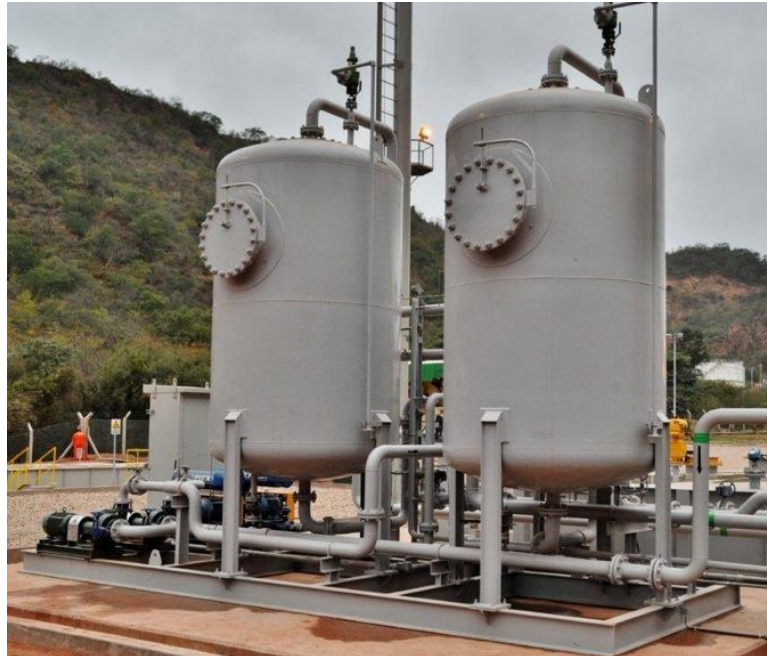
Figura 24. Imagen tanque de filtración
