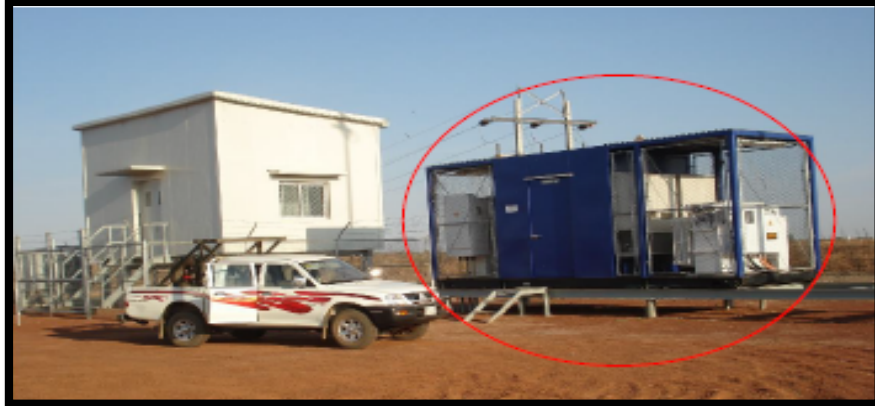
Figura 12. Equipos de bombeo electrosumergible de superficie
