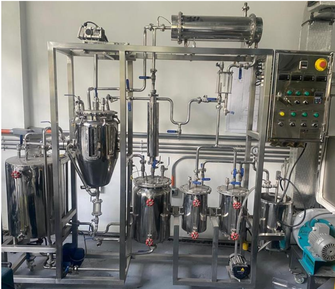
Planta de extracción multipropósito del CEPIIS
